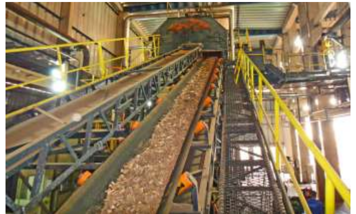
Transportador de correia para alimentação de caldeira
